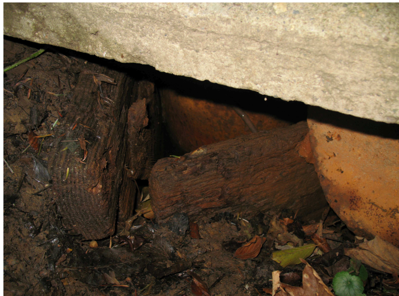
Ryc. 22. Stanowisko badań Nr 3. Kopanka mokra, ropna zabezpieczona od góry płytą betonową; widoczna dobrze zachowana drewniana cembrowina. Gm. Iwonicz-Zdrój, woj. podkarpackie, 2011.
