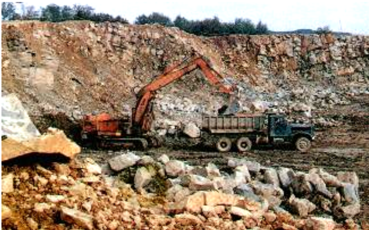
Fot. 1. Kamieniołom w Lipowicy k/Dukli (woj. podkarpackie). Minimalna szerokość eksploatacyjnego poziomu przyjęta jest na 15 m. Wysokość ściany eksploatacyjnej wynosi średnio około 11 m, zaś w spągu warstw łupka może dochodzić do 14 m. Kąt nachylenia ściany eksploatacyjnej i ociosów \alpha = 85^\circ .
